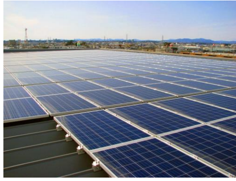
【屋上に設置した太陽光パネル】
